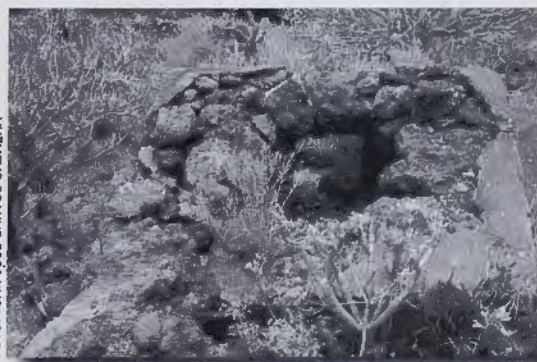
Pequeño horno seriamente dañado por la construcción de una carretera en Las Indias, Fuencaliente.
